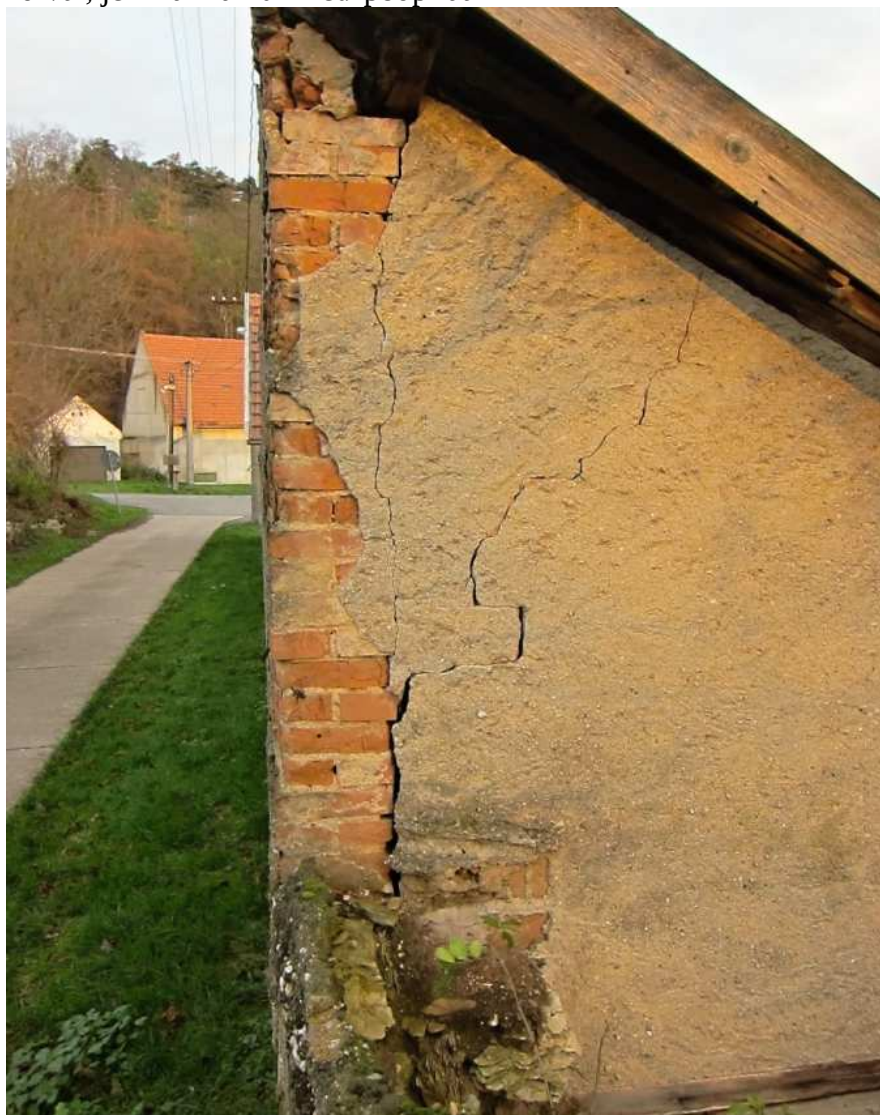
Foto č.6 - kolny na hranicích pozemku č. 122 - pohled z boku, kde jsou vidět trhliny v bočním zdivu , jež má hraniční zed' podpírat
