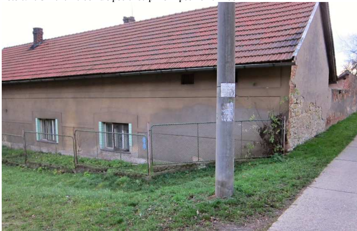
Foto č.2 a 3 - ukázka domů s podlahou přízemí pod komunikací
