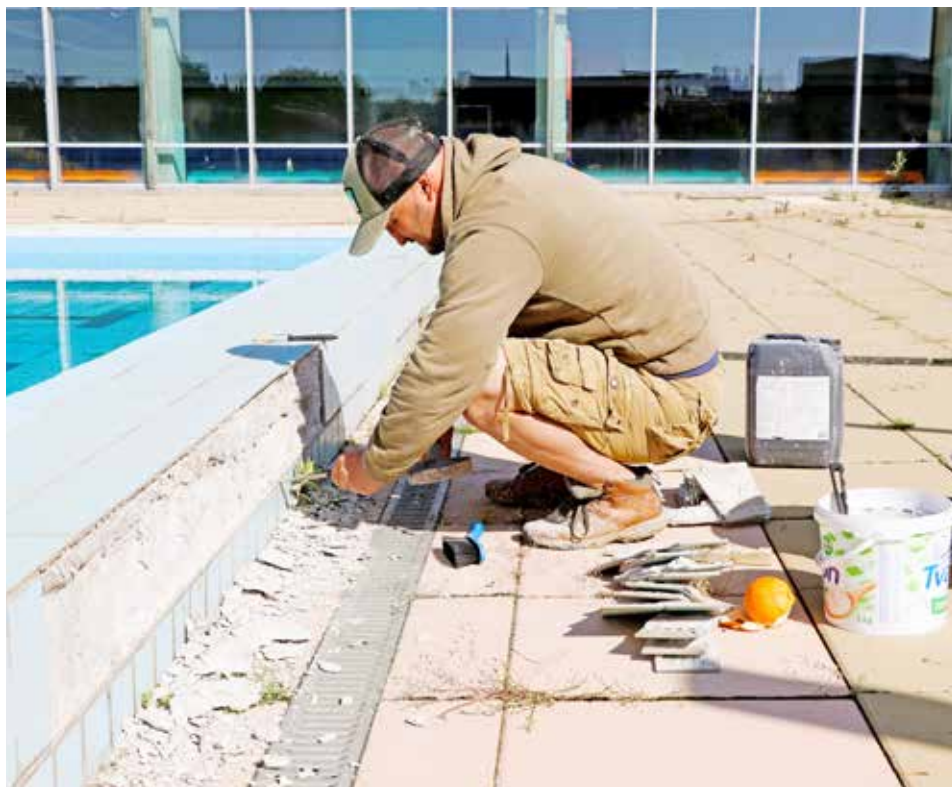
Opadané keramické obklady na venkovním bazénu v Přerově bylo nutné opravit
