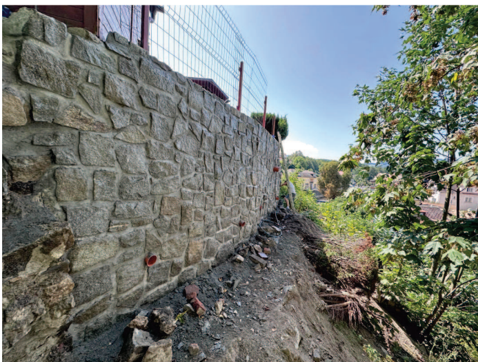
nová opěrná zídka pod objektem č.p. 1, zničená povodní 2024
